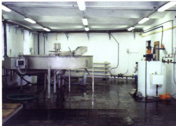
Flotační stanice v mlékárně
