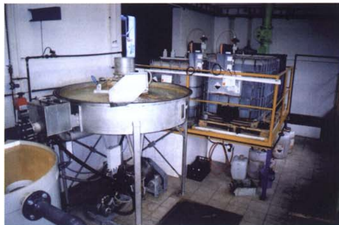
Flotační stanice v hliníkárně
