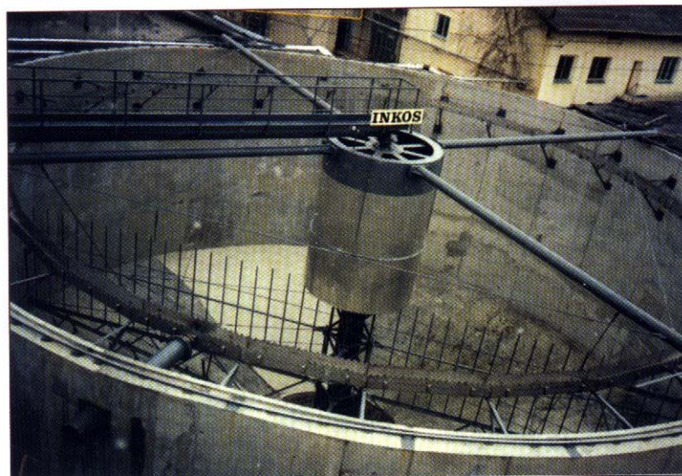
Zahušťovací nádrž kaolinové suspenze ZN 24/8
