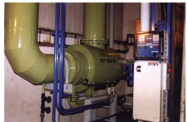
Filtrační stanice chladící vody v elektrárně
